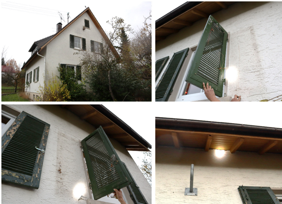
Abbildung 4: Fotos des Hauses und exemplarisch der für Fledermäuse relevanten Strukturen wie Fensterläden und Schadstellen unterhalb des Dachs
